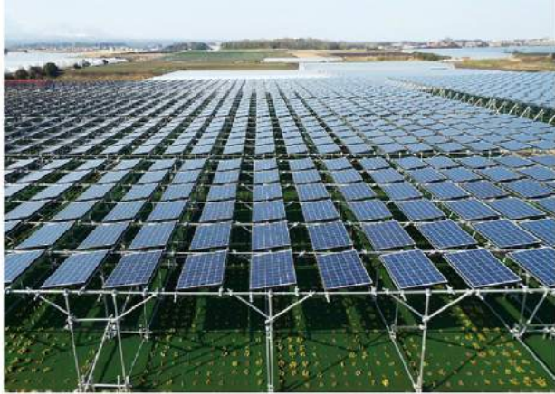
北栄ソーラーファームの全景（鳥取県北栄町）
